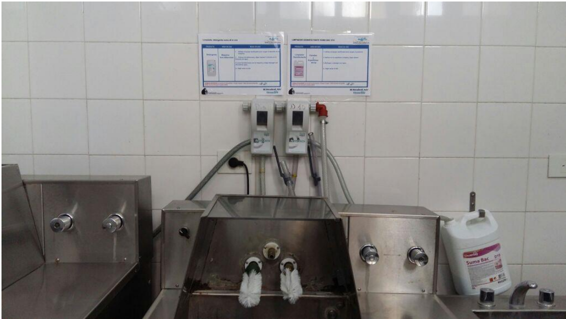
Imagen 5 y 6 - Área Sucia – instalación de dosificadores y reemplazo de productos químicos
