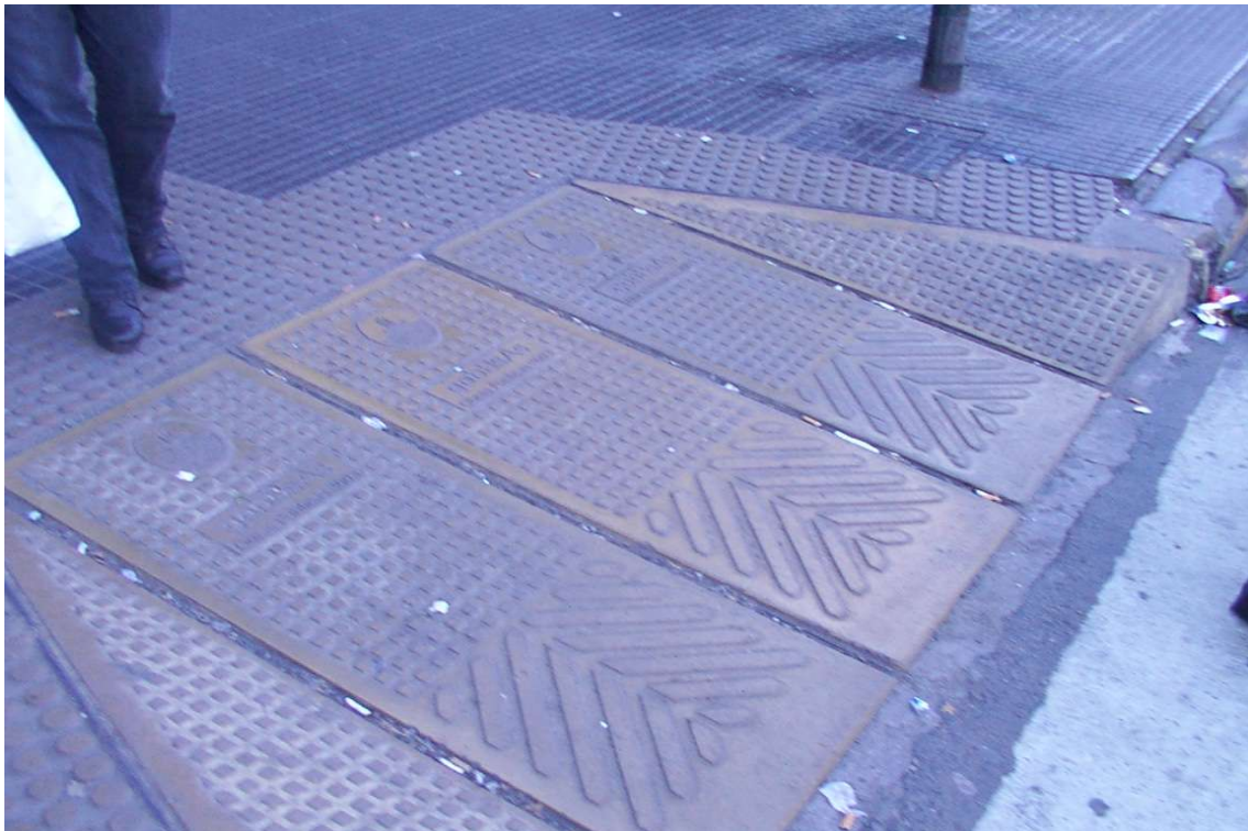
2- Imagen de la rampa que salva la altura del cordón de la vereda, desprovista de pasamanos.
