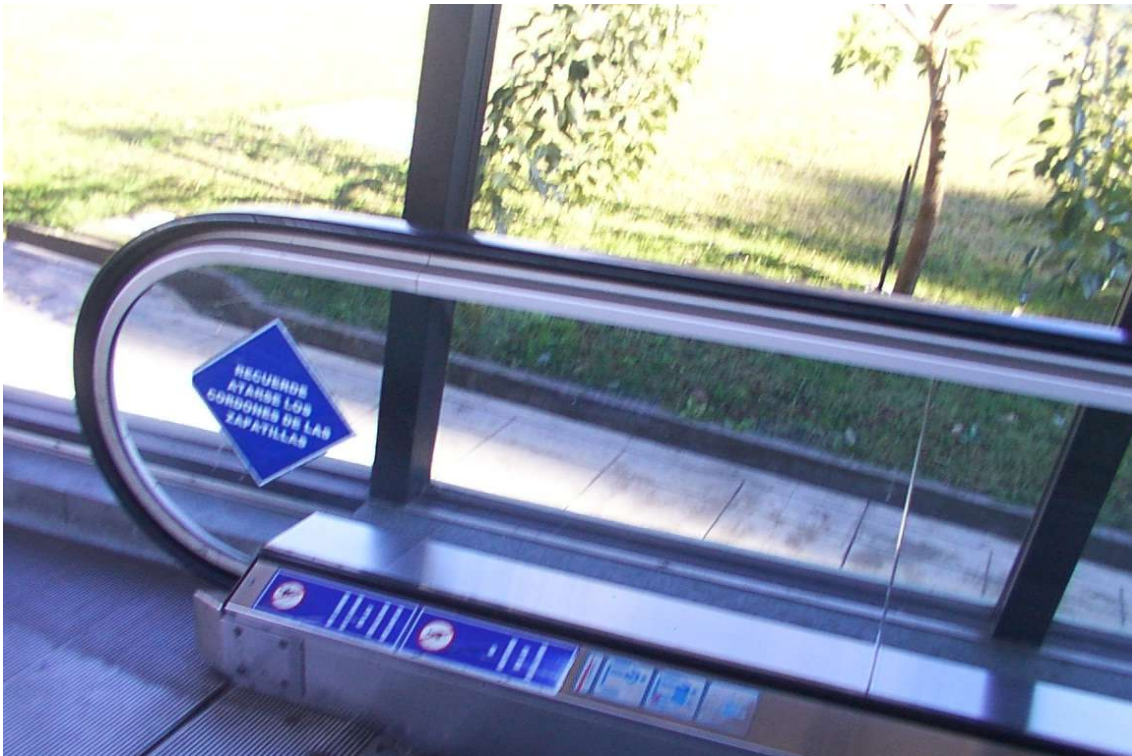
7- Esta imagen refleja que la escalera mecánica tiene carteles de prevención, con colores contrastantes y pictogramas.
