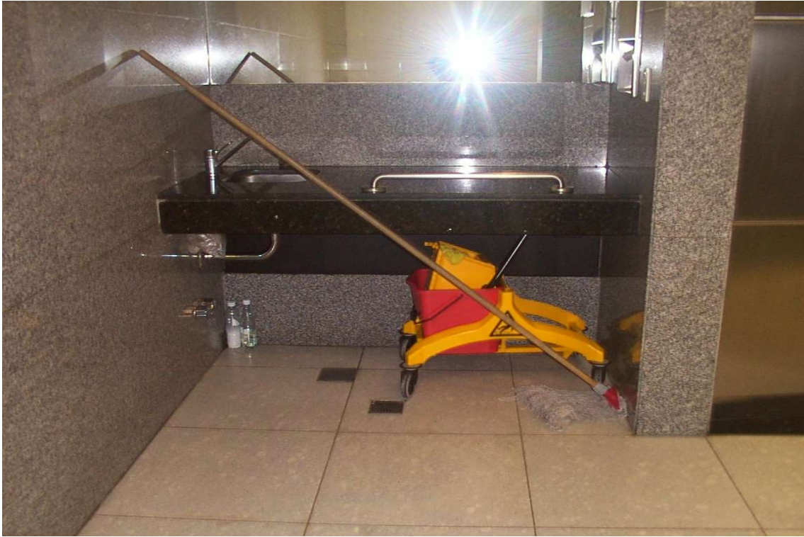
24- El lavabo se halla fuera del retrete adaptado, tiene una barra de apoyo, espacio para colocar debajo la silla de ruedas y una canilla facil de accionar (automática). El espejo no está inclinado.
