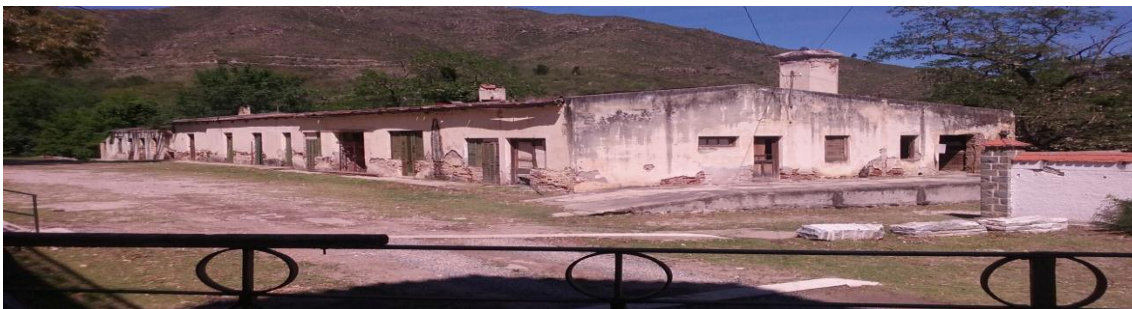
Sector de mantenimiento del hotel Edén, uno de los lugares que más miedo les da transitar a los visitantes, tanto de día como de noche, debido al deterioro presentado allí. Detrás se puede observar el cementerio del hotel de ese momento.
